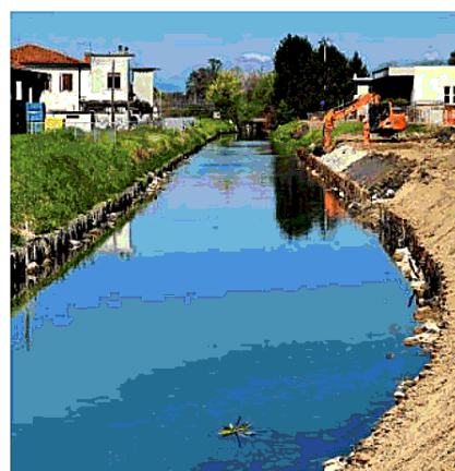
Sicurezza idraulica Lavori in corso su una delle sponde del Tesinella M.M.
